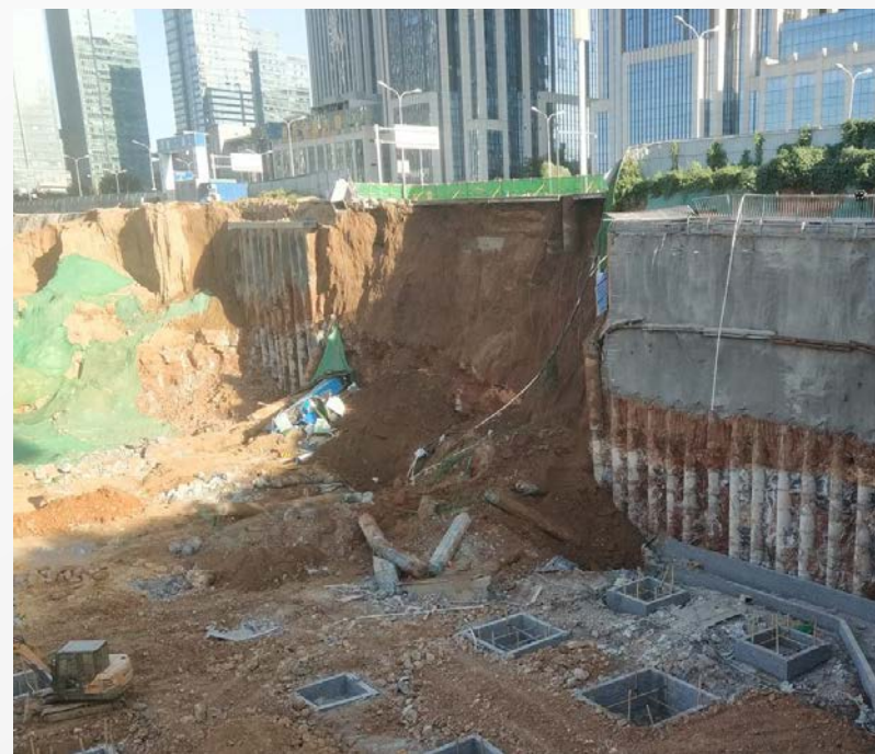
不按设计施工导致基坑坍塌
